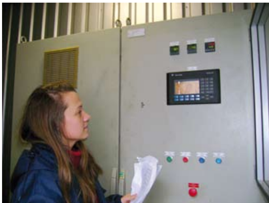
Une inspectrice de la DRIRE contrôle une installation.
