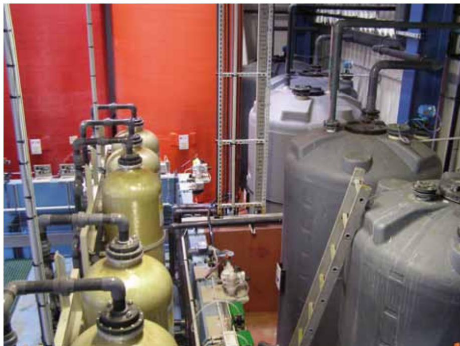
La société MBDA a installé une station « zéro rejet eau » pour son traitement de surface.
