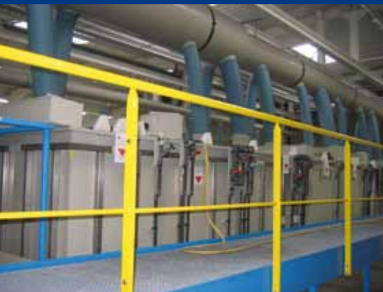
Chaîne de traitement de surfaces de la société DEC à Cormenon.
